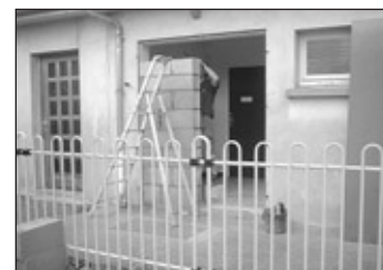
Changement des portes aux sanitaires avec simple porte d'accès et peinture des intérieurs.
